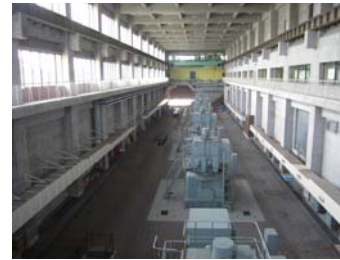
排水機場の6台のポンプ
