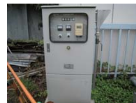
地下水汲み上げポンプ
