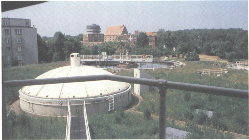
リン浄化施設
