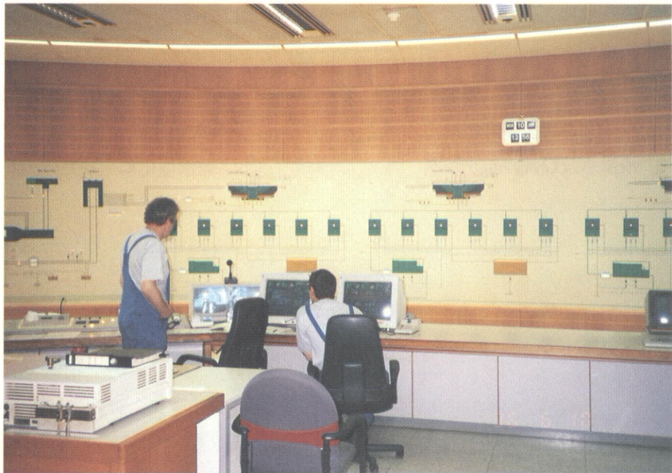
リン浄化施設の操作室
