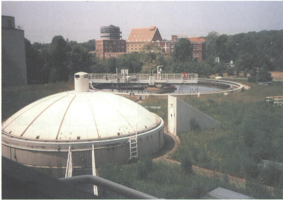
リン浄化施設
