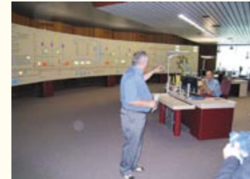
チューリッヒ市水道局の監視室では3つの浄水場と市内配水をコントロールしています。湖水、伏流水、湧水と3つの水源を確保し危機管理対策をとっています。
