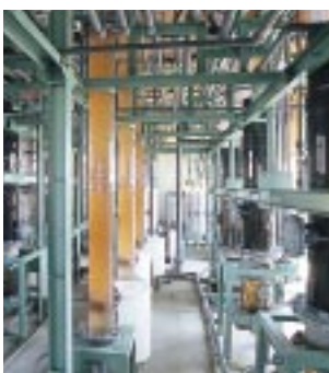
超高度処理のパイロットプラント
