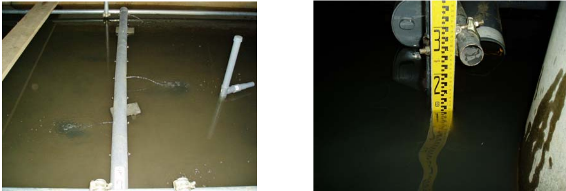
図 3-3 湛水状況 (D-2 槽)
