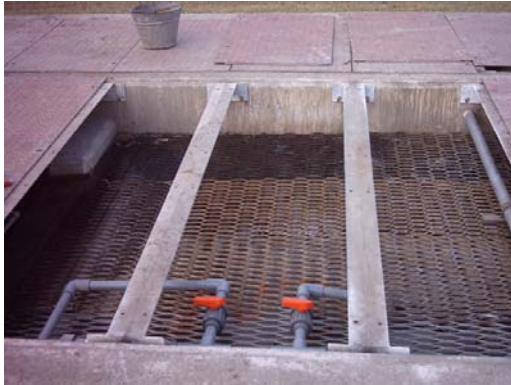
図 3-4 接触ろ材槽(第1槽)
